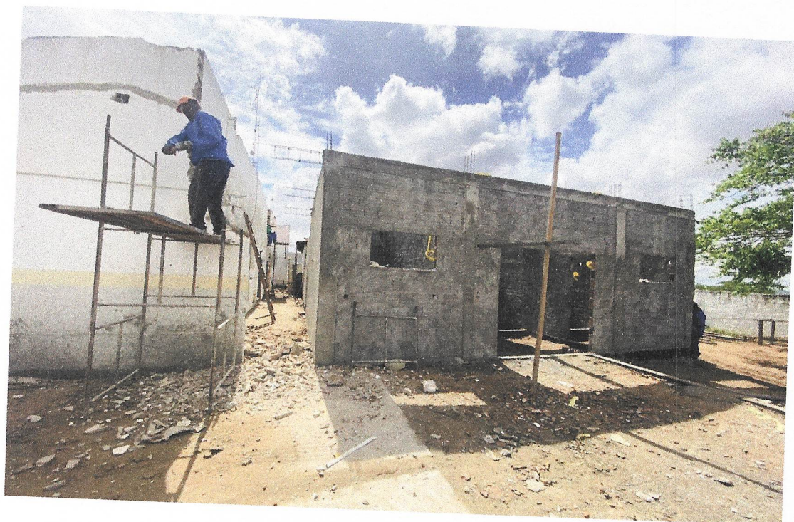
Foto 16 -- CHAPISCO APLICADO EM ALVENARIAS E ESTRUTURAS DE CONCRETO INTERNAS, COM COLHER DE PEDREIRO
