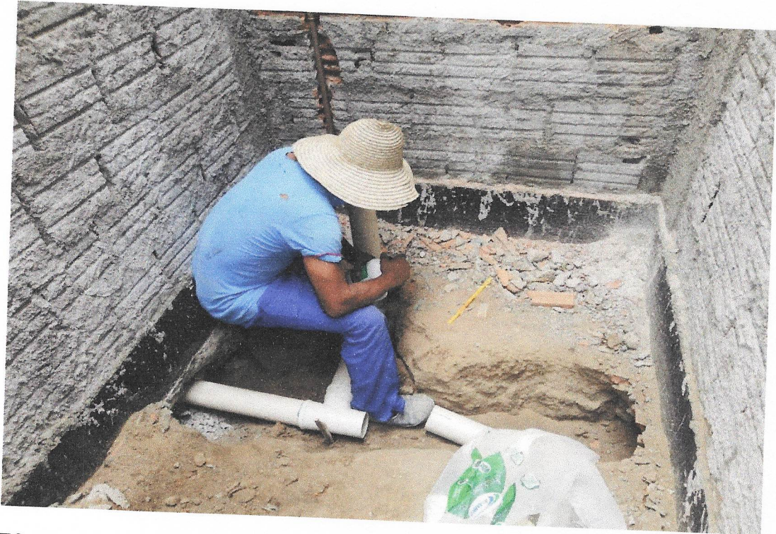
FOTO 23 - Ponto de esgoto com tubo de pvc rígido soldável de Ø 100 mm (vaso sanitário)
